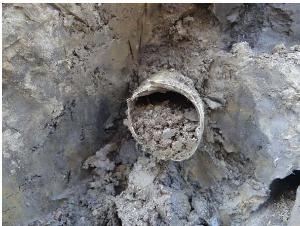
Slika 7. Zapušena drenažna cev
