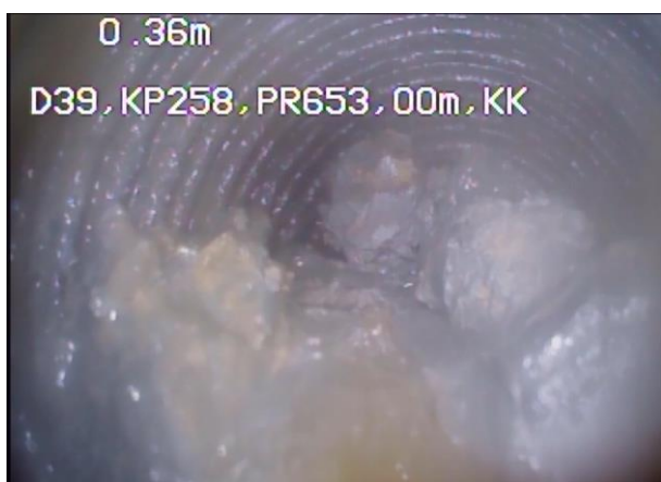
Slika 8. Zapušena drenažna cev – snimak kamerom
