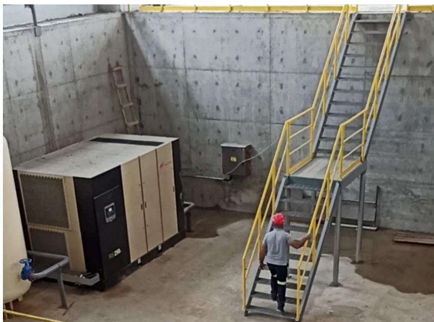
Slika 4. Kompresorska stanica u pogonu za pripremu pasta zasipa
