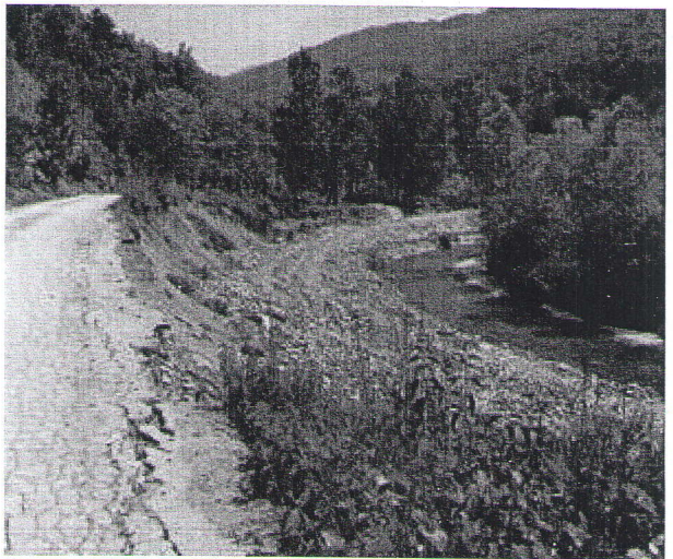
Слике 6. Уништена путна инфраструктура Figure 6. Road infrastructure destroyed
