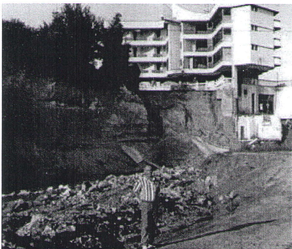
Слика 7. Оштећен хотел у Варварину Figure 7. Damaged hotel in Varvarin
