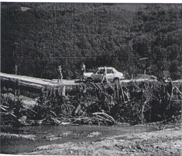
Слика 4. Део моста уништен поплавом на Власини у јуну 1988. године
