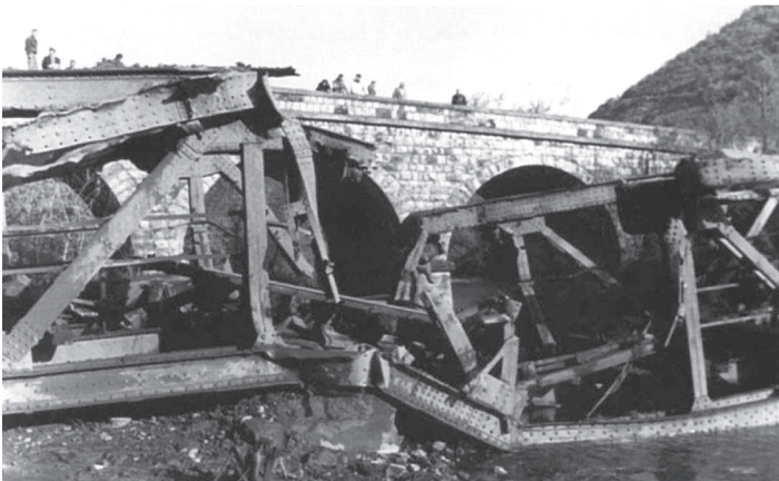
Срушени железнички мост Лопатница, поред каменог аутомобилског моста. 16
